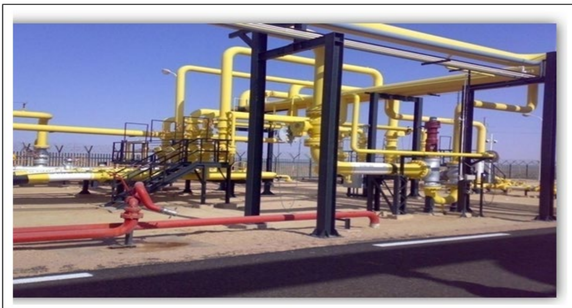
Figure II.2 : Point de collecte des différents centres de séparation
