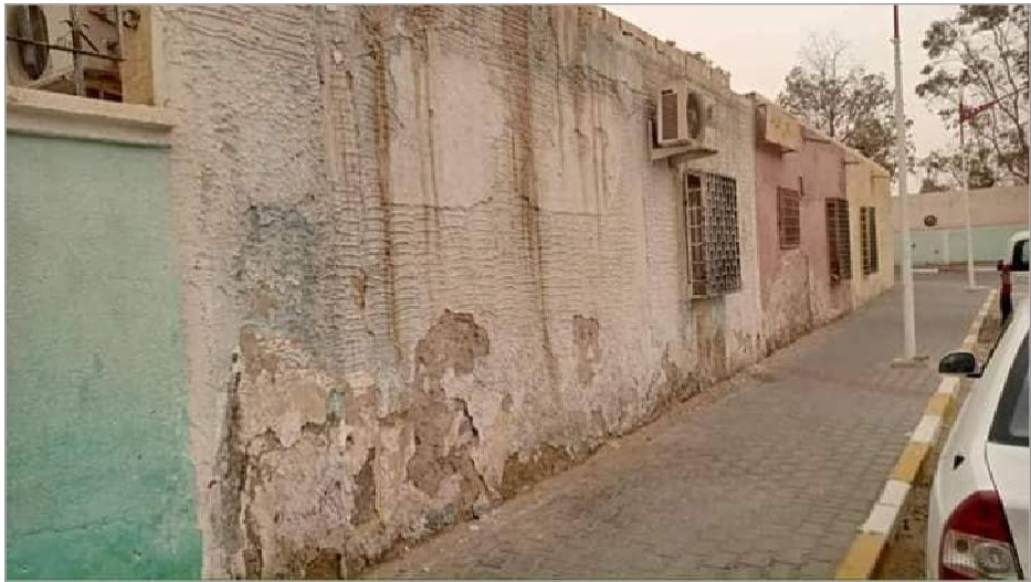
Photos N°01 : Remontée des eaux dans les zones urbaines (Source : Étude de terrain, mai 2022).
