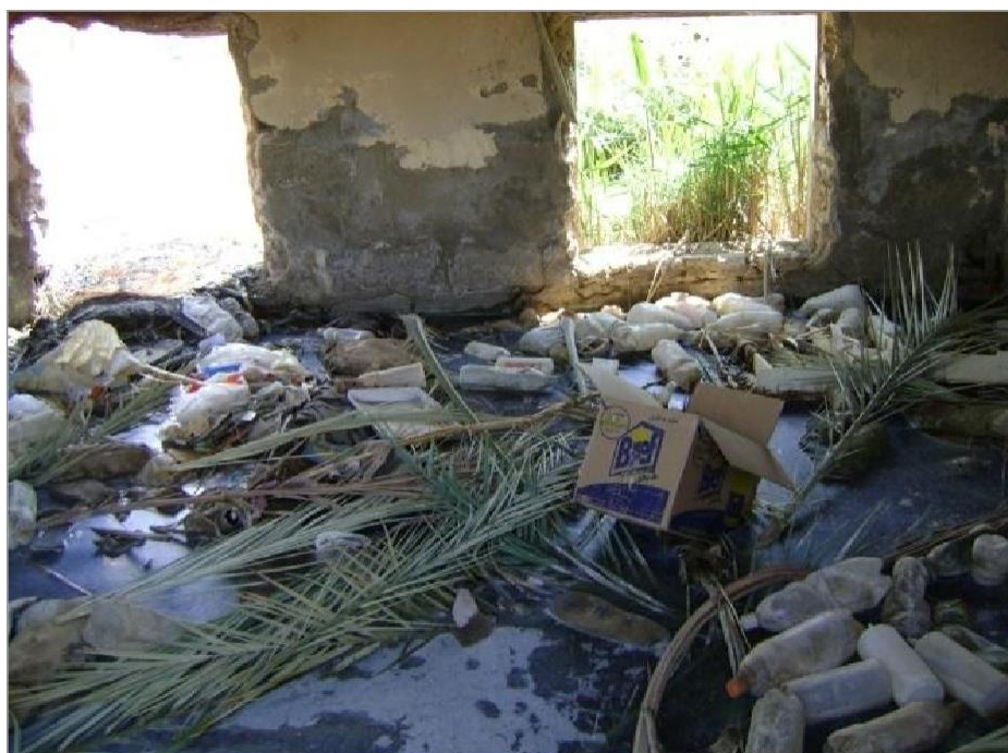
Photo N°02 : Quartiers touchés par la remontée des eaux dans les agglomérations urbaines de la commune d'El Oued (fin 2020) — Source : Direction de l'Urbanisme et de la Construction, wilaya d'El Oued, mai 2022
