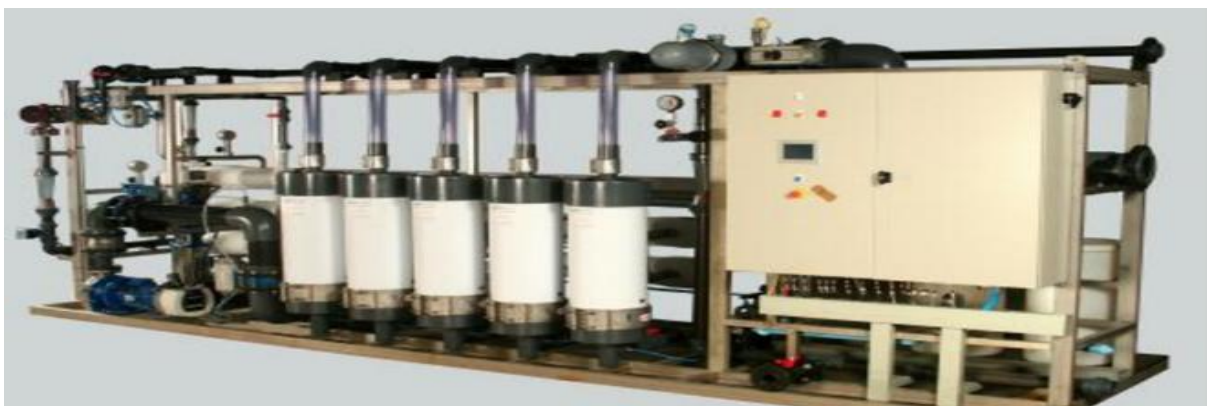
Fig.IV.10- L'unité compacte membranaire[10]
