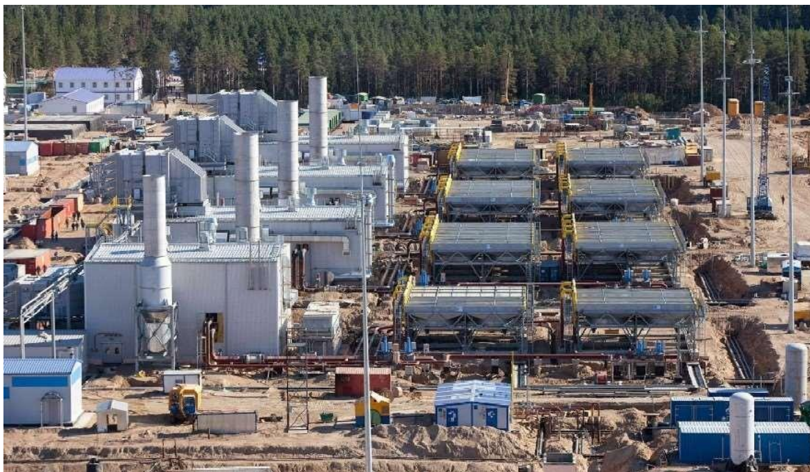
Figure IV.1: Une station de compression avec (turbocompresseurs)
