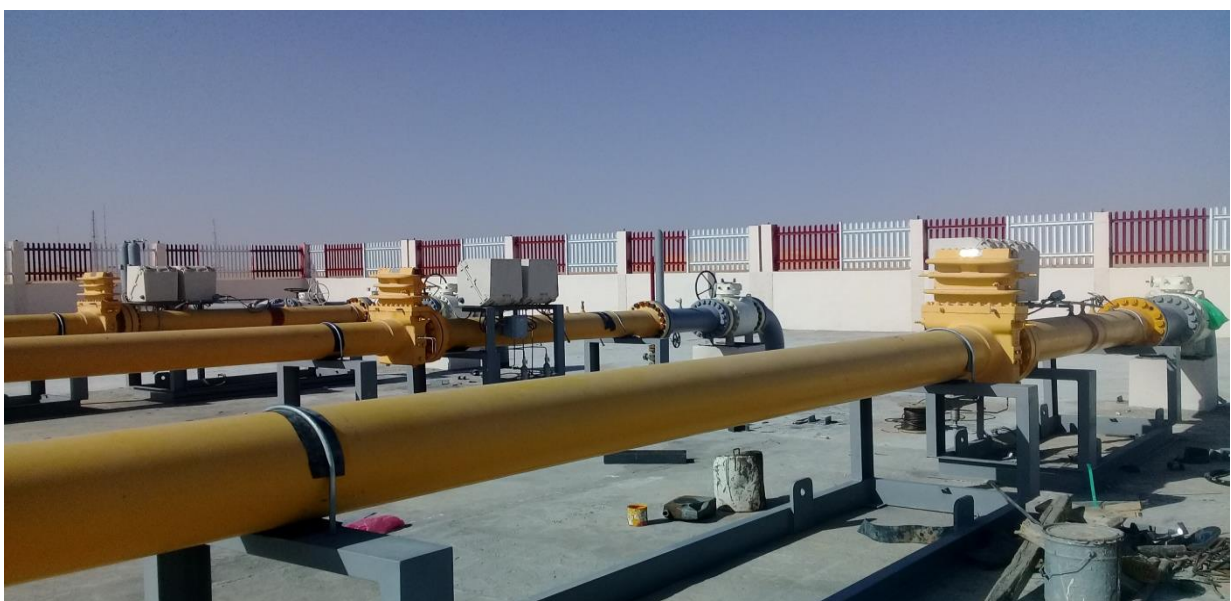
Figure III.11 : Poste de comptage (Hassi Messaoud-El oued)
