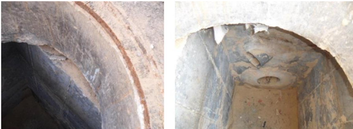
PHOTO II.3 : Regard n'est pas en service.
