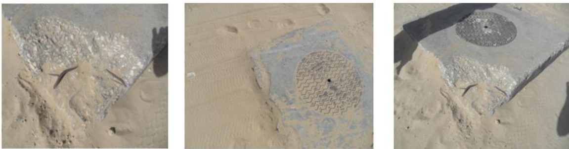
PHOTO II.4 : désagrégation en béton.
