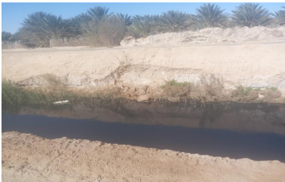
Photo(IV.1) : dégradation du canal région Mégarine(Bouaichi et B.A.Allah 2019)
