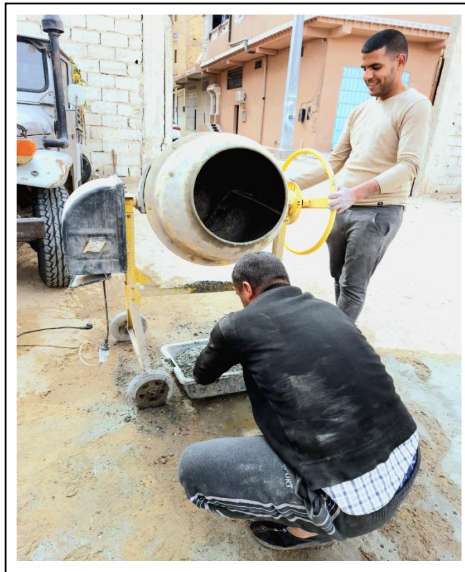
photo III-01: Bétonnière utilisée pour le malaxage des bétons
