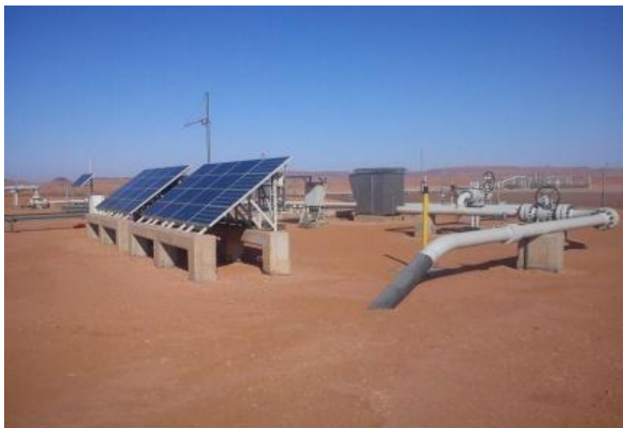
Figure II.8: Panneau solaire (générateur photovoltaïque)
