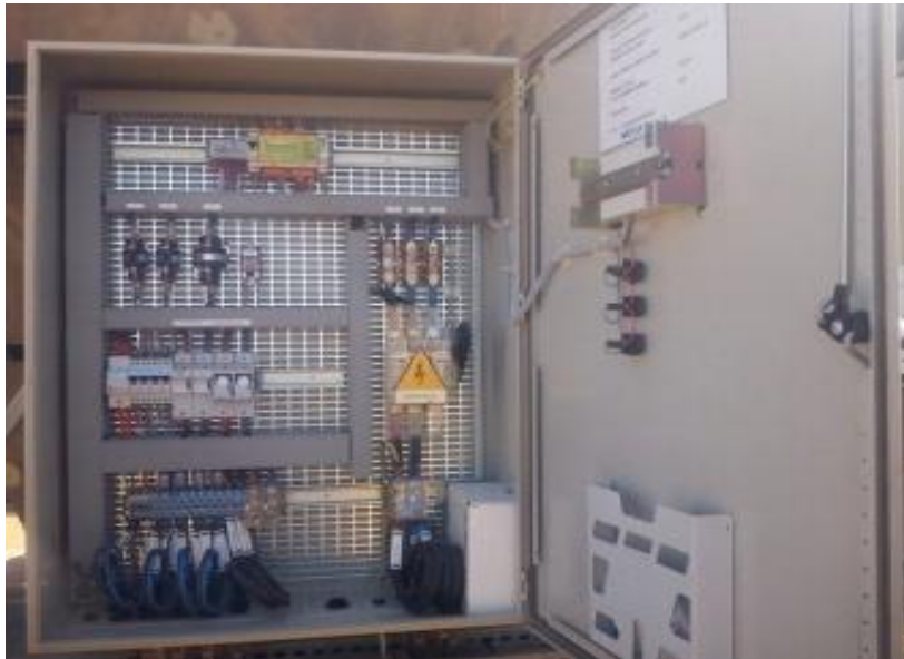
Figure II.10: Régulateur de charge des batteries
