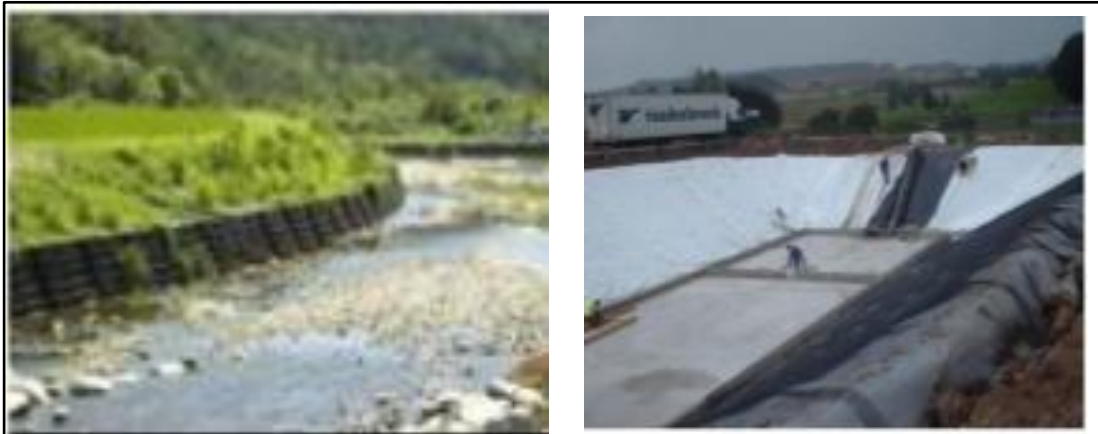
Figure 1.24: les géosynthétiques dans les bassins de traitement[7][9]
