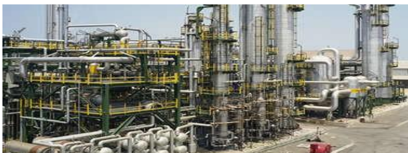
Figure I.2 : Vue d'une installation de traitement du gaz naturel [14]
