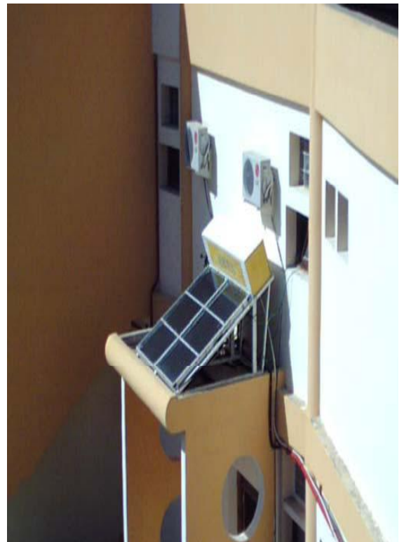
Figure III.2 : Vue de chauffe-eau solaire installé.
