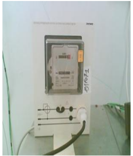
Figure III.6 : Compteur d'énergie électrique.
