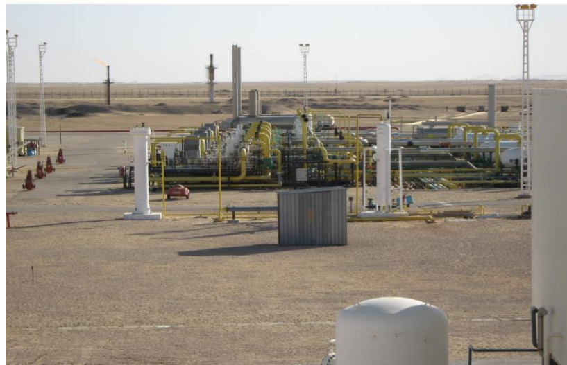
Fig.III-4: Photo d'installations de traitement du gaz naturel
