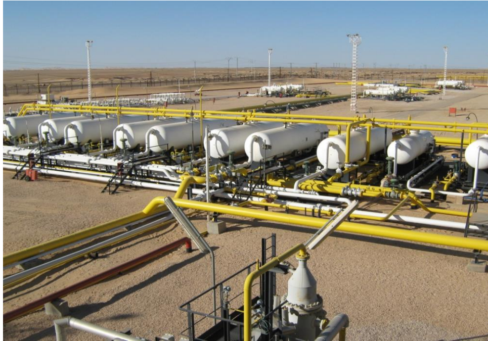
Fig.III-2: Photo de l'installation de traitement du brut
