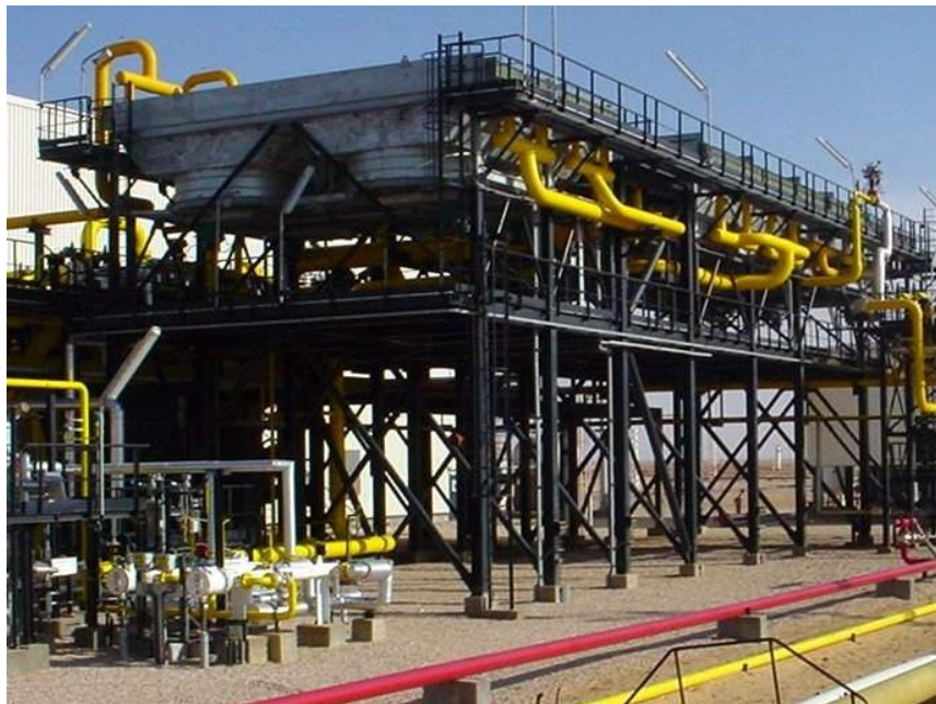
Fig.III-5: Photo Unité de récupération des gaz associés
