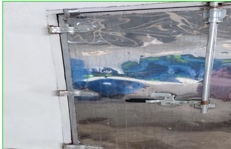
Figure13 : Chambre de la chaudière (Dhawya, 2022).
