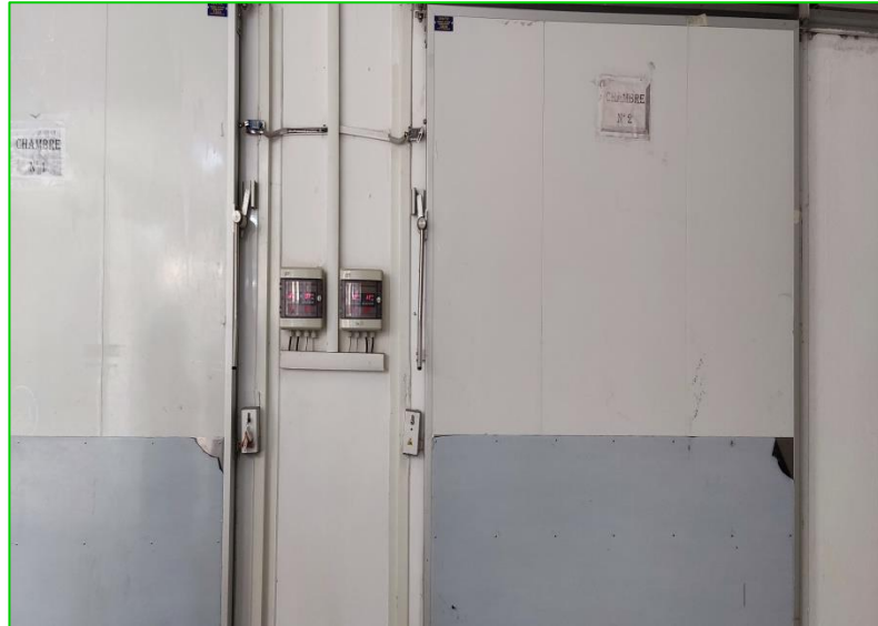
Figure15 : Chambre de froide (Dhawya, 2022).
