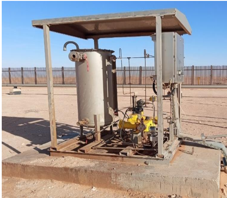
Figure 50 : système d'injection l'inhibiteur de corrosion
