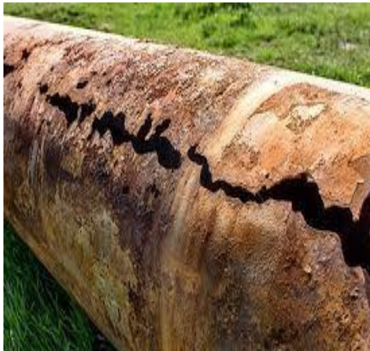
Figure 16 photos de la corrosion dans une canalisation [21]
