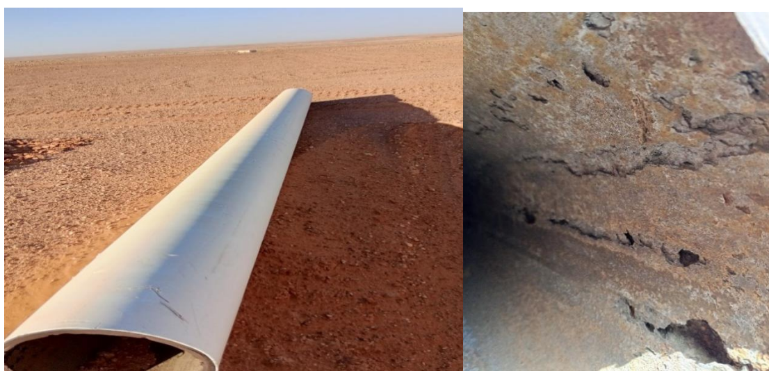
Figure 42 : tronçon de pipe à changer
