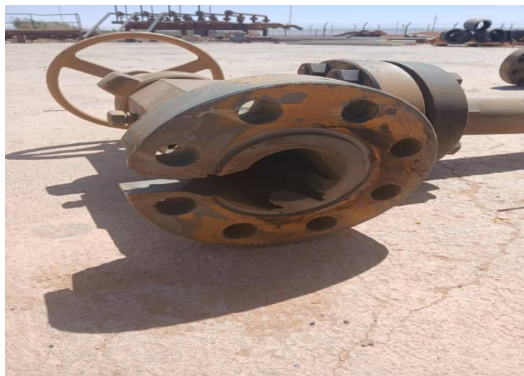
Figure 15 : Photo de la corrosion caverneuse. Attaque visant les pièces métalliques moins exposées à l'oxygène [05]
