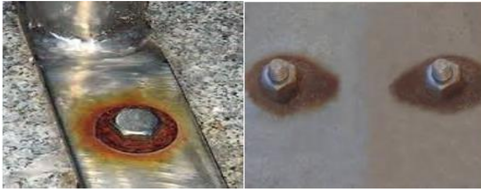
Figure 12 : Photos de la corrosion galvanique. Produit lorsque deux métaux différents [05]
