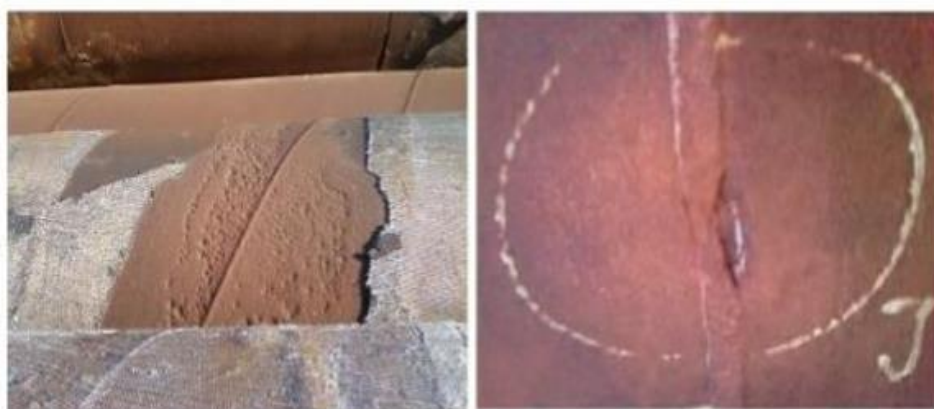
Figure 18 : Corrosion des Pipelines la corrosion, qui cause des dommages aux canalisations [21]
