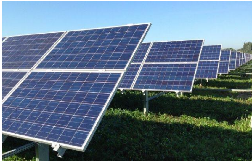
Fig. (I.2) : Panneaux solaires photovoltaïques
