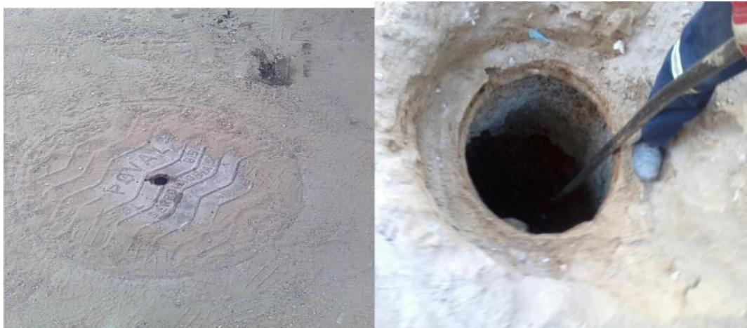
Photo IV.3 : tampon en état acceptable Photo IV-4 : Bonne tampon et structure
