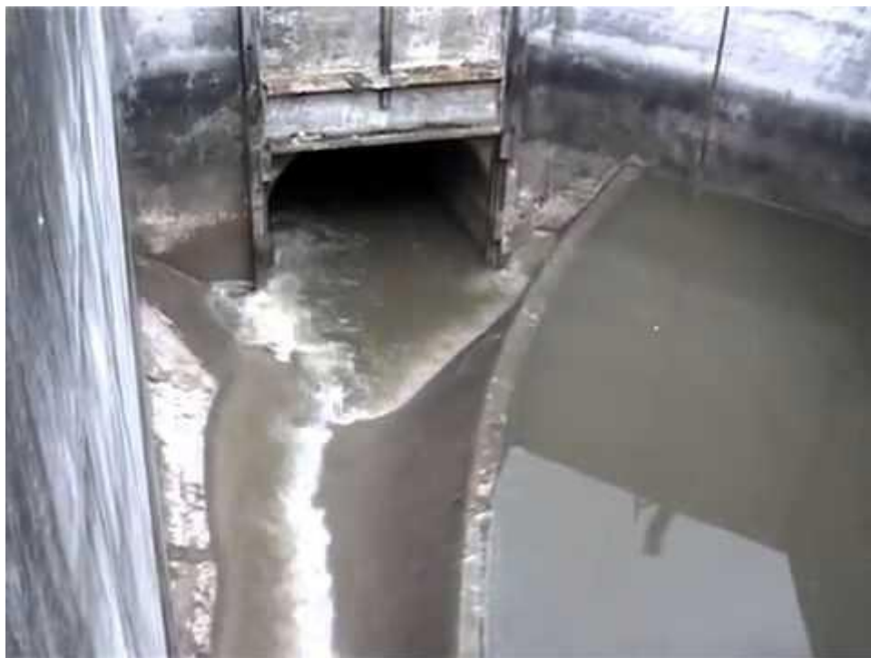
Figure I.7 : Un déversoir d'orage
