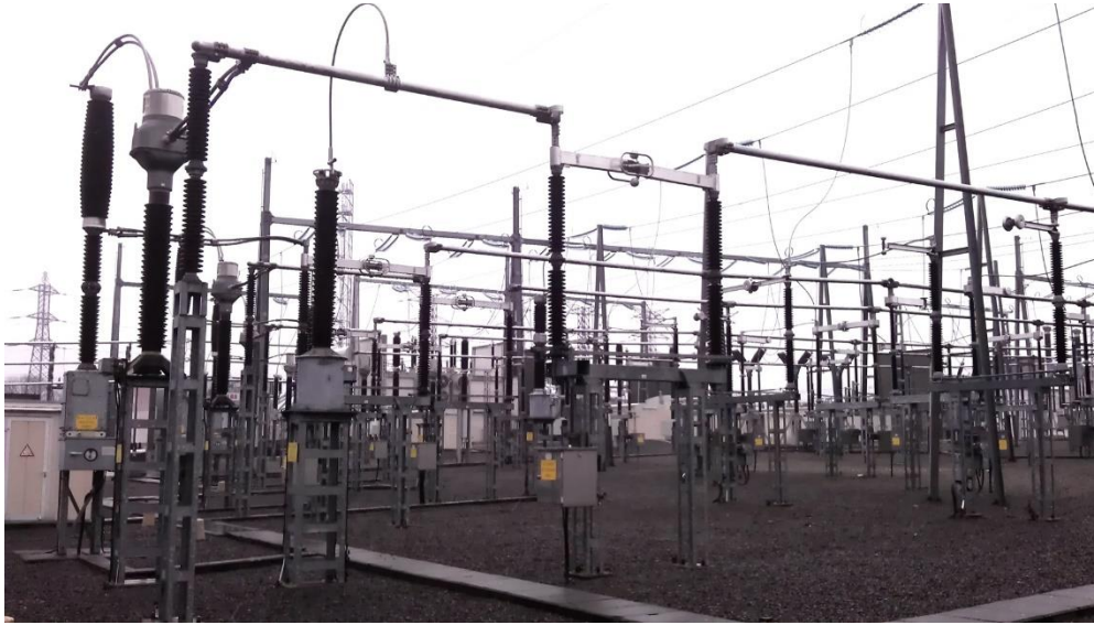
Figure III.6 Photo réelle d'un jeu de barre 225 KV
