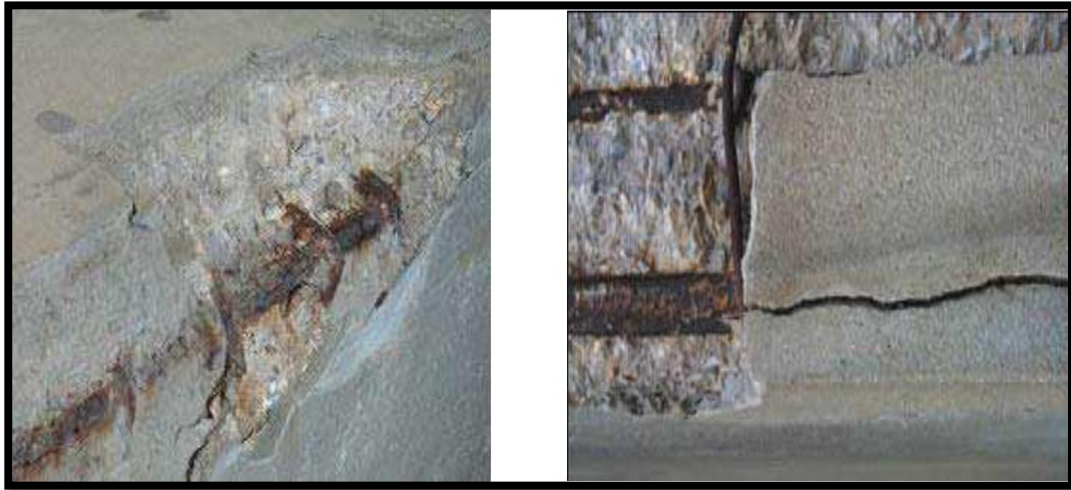
Figure II.1: Exemples de corrosion par carbonatation [31].
