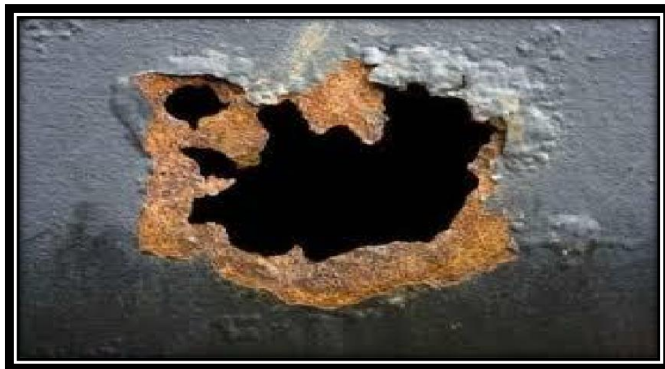
Fig I.2. Corrosion par pique [15].
