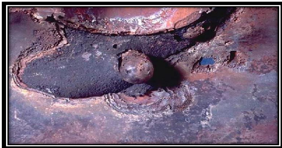
Fig I.3. La corrosion galvanique [16].
