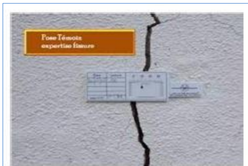
Figure I.16. Fissure de béton.
