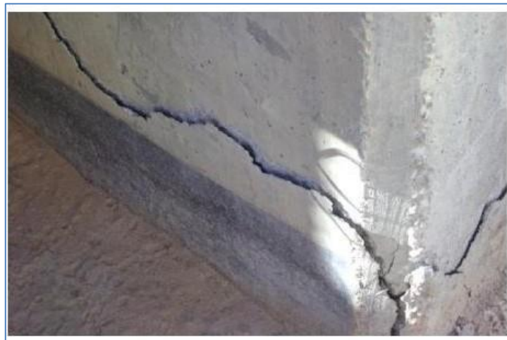
Figure IV.6: Gonflement et éclatement du Béton.
