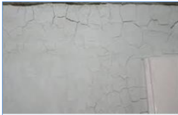
Figure I.18. phénomène de faiençage.
