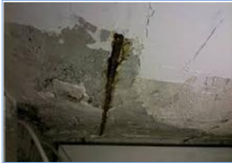
Figure I.20. Lichen sur la structure.
