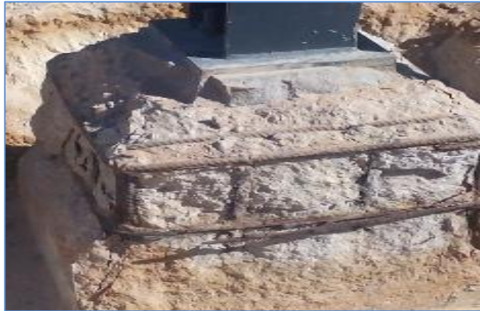
Figure I.13. corrosion de l'armature.
