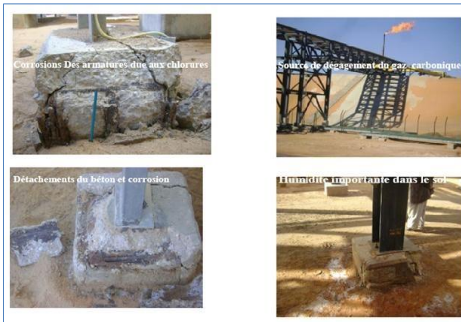
Figure IV.4: l'état du béton.
