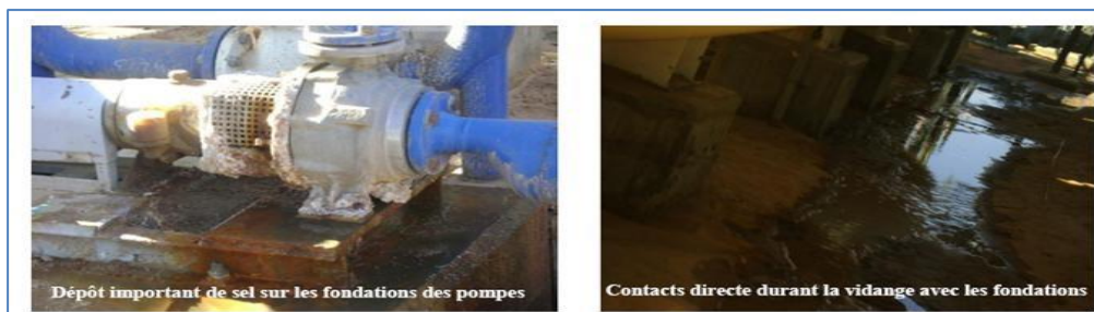
Figure IV.2: des dégradations importantes au niveau des massifs supports.
