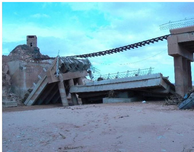
Fig.9. Dégâts de la crue de 19 Octobre 2007
