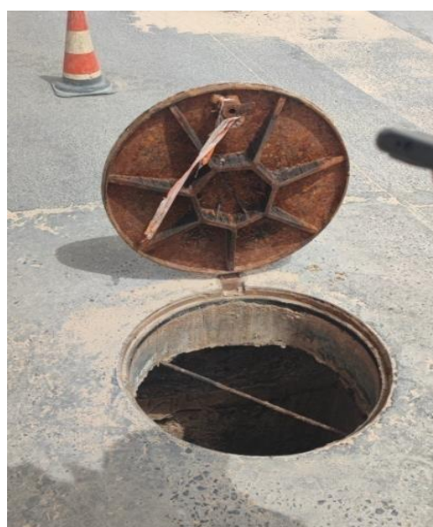
Photo 3.3 : tampon en état acceptable
