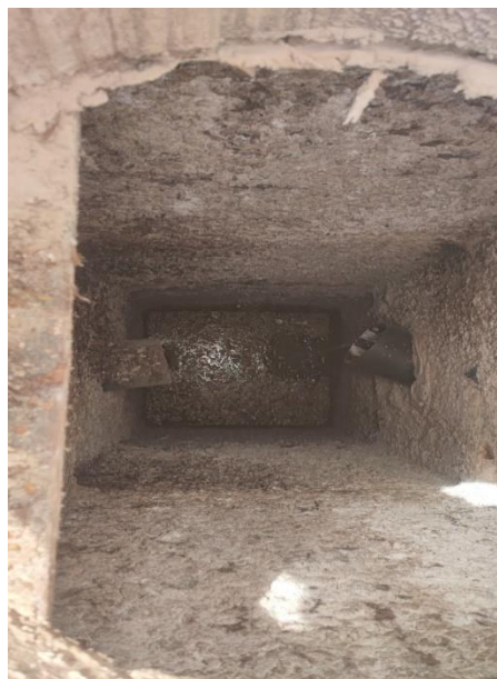
Photo 3.2 : branchement non réguliers
