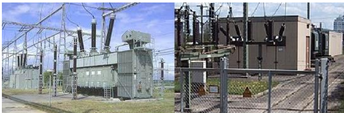
Figure (I.2) : Les postes d'interconnexion
