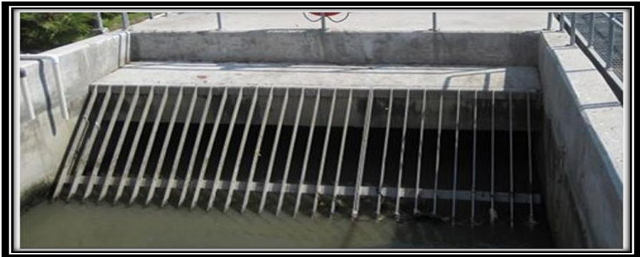
Fig. 8 : Dégrilleur à nettoyage manuel
