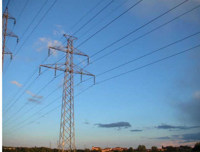
Figure I.8.1 Pylône métallique, ligne 220KV[5]
