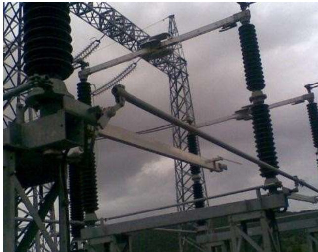
Figure II.5.5 Sectionneur de mise à la terre [12]
