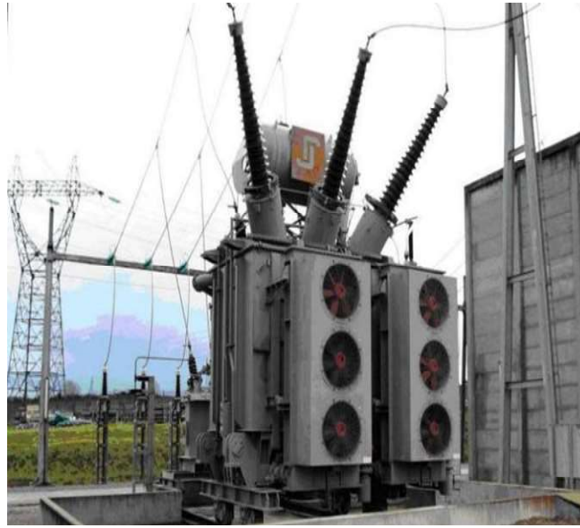
Figure II.5.3.1 Vue de face d'un transformateur de puissance 220/63 kV (100MVA) [8]
