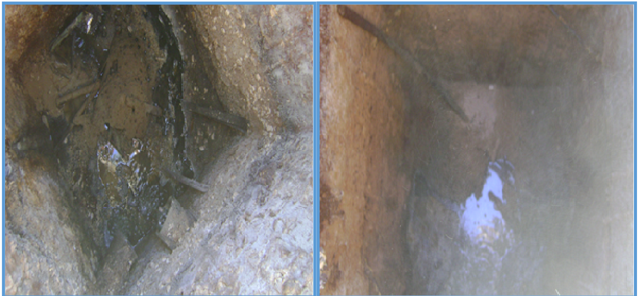
Photo IV.7 : déchets bouchant les regards.
