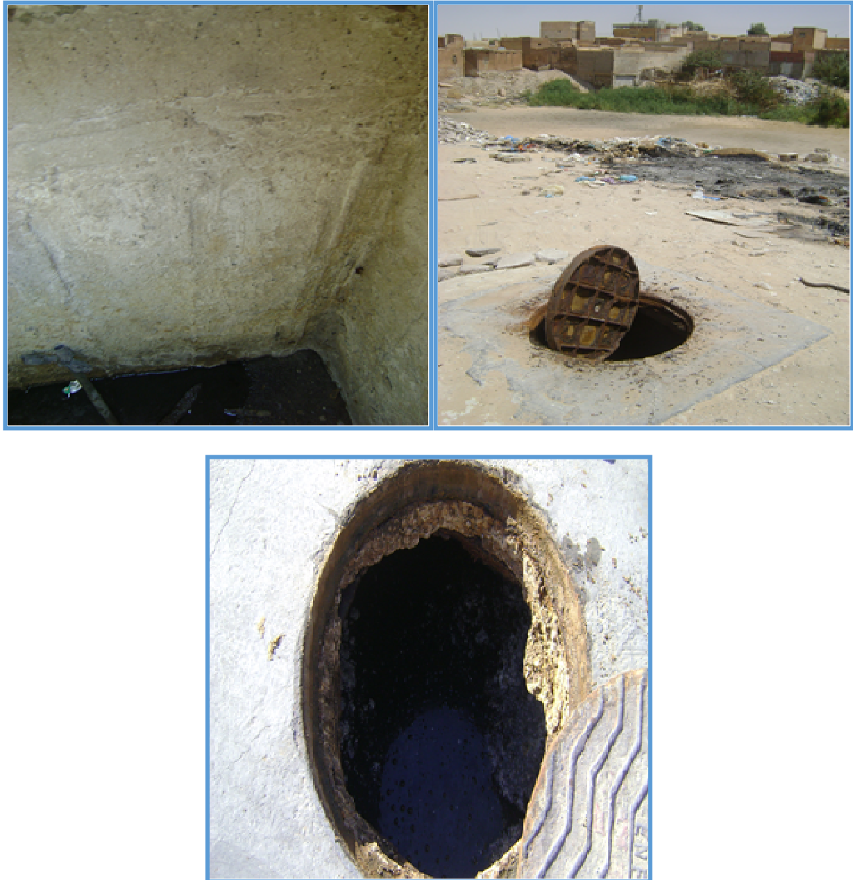
Photo IV.4 : désagrégation en béton.
