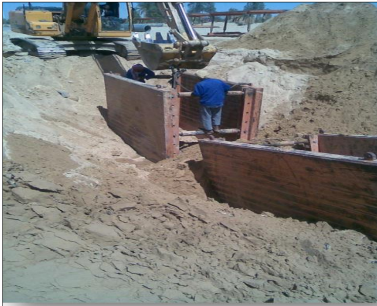
Photo VIII -1 : La protection contre les éboulements.
