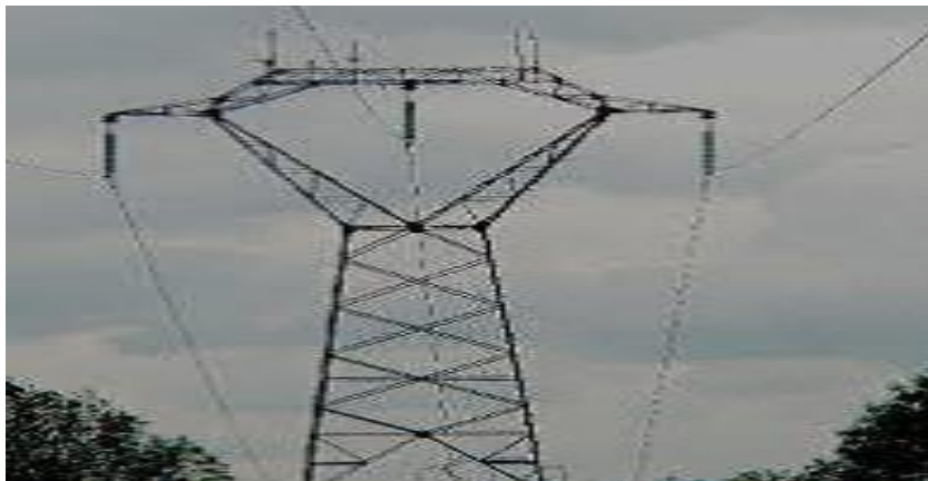
Figure II.1 : Pylône français supportant deux lignes 230/400 (420) kV : trois paires de conducteurs et une paire de câbles de garde pour chaque ligne, avec chaînes d'isolation à 19 éléments
