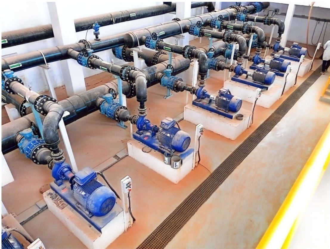
Image II.13: Pompes d'eau traitée.
