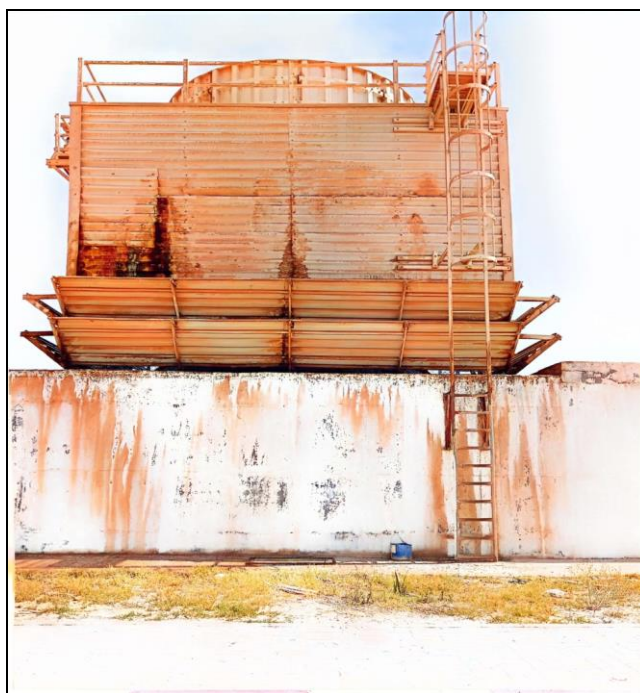
Image II.5: Tour de refroidissement
