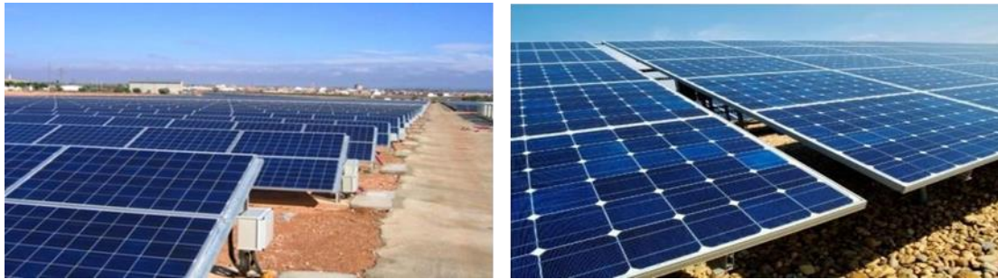
Figure(1.2): stationsolaired'AinElbelDjelfad'unecapacitéde20mégawatt et Centrale solaire Ain Skhouna à Saïda d'une capacité 30 MW depuis mai 2016 [1]
