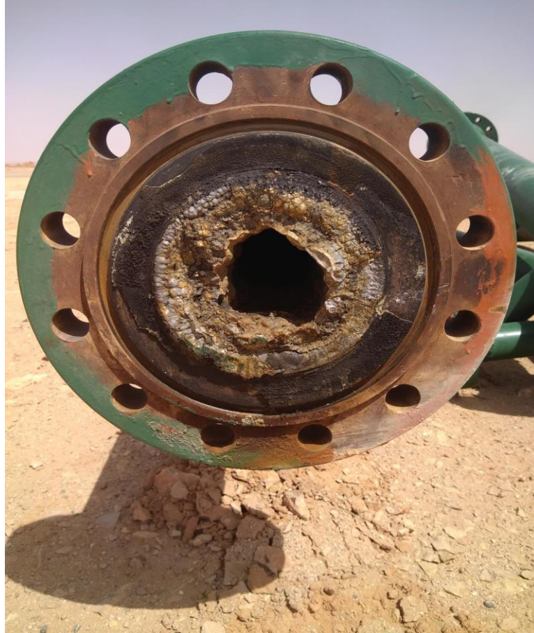
Figure II.4 : image originale du sel de sulfates de baryum formé dans une conduite da la zone de TFT
