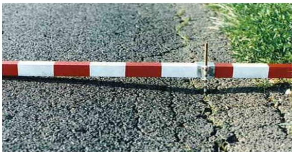
Figure 5 Affaissement de Rive [3]
