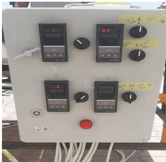
Photo (III.14) : Armoire de mesure de température.
