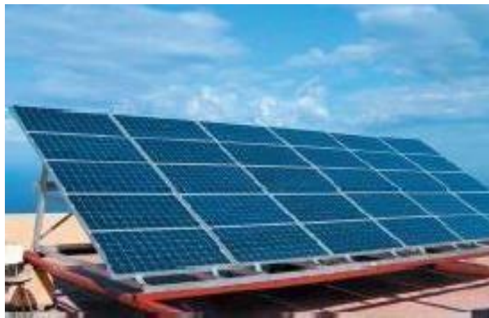
Figure I-3 Vue d'une installation photovoltaïque [6].
