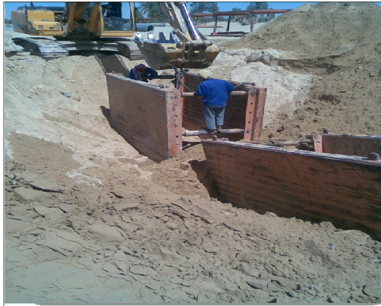
Photo VI -1 : La protection contre les éboulements.
