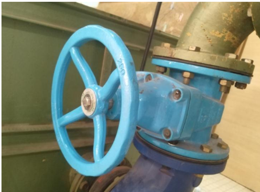
Figure I.3: Photographie de La vanne de régulation du débit (Laboratoire Université Ouargla).
