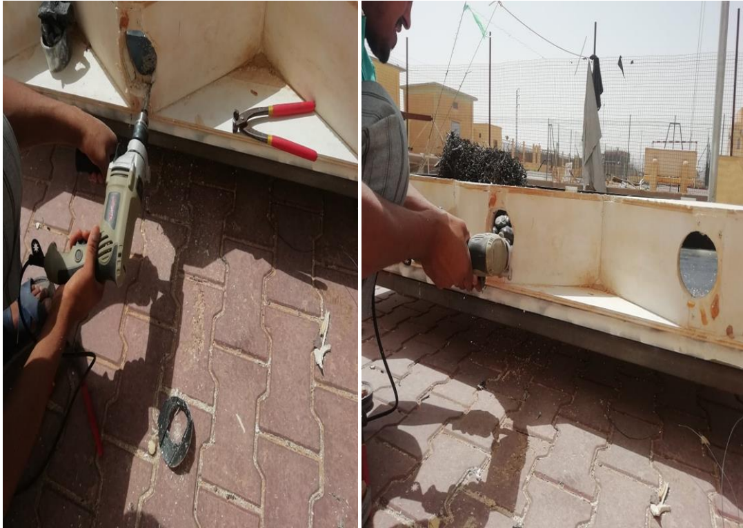
Fig montrant l'installation du collecteur solaire
