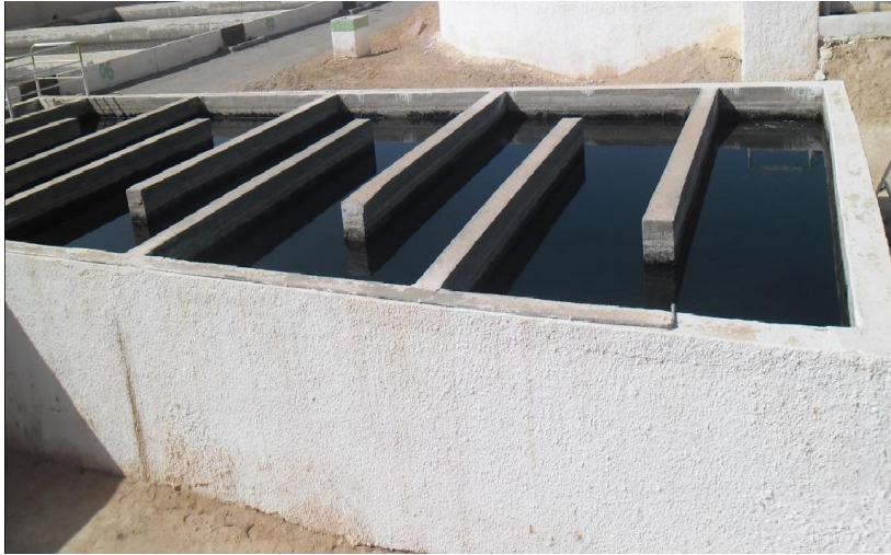
Photo.06: Bassin de chloration.
