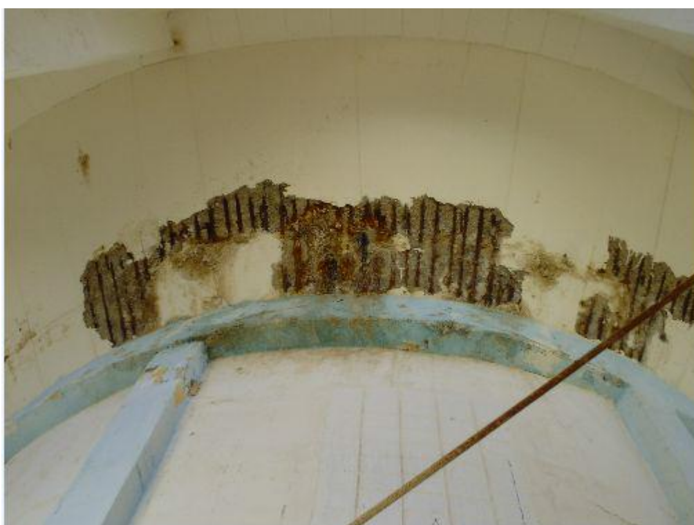
Photo.05.: Corrosion de quelques armatures apparentes de la coupole inferieure de la cuve
