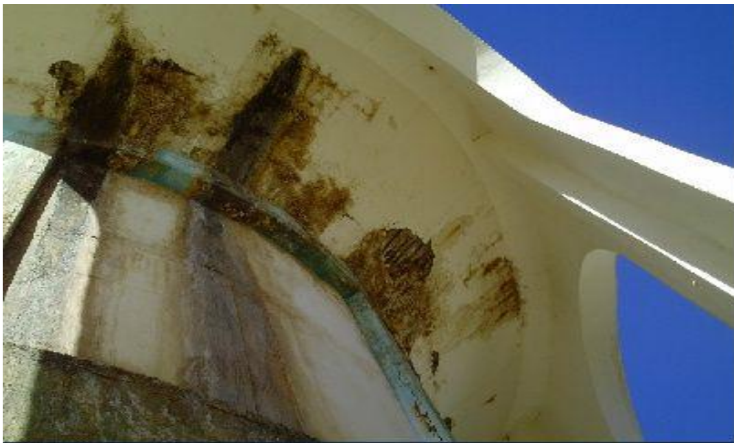
Photo.07.: Traces d'infiltration d'eaux colmatées par le temps au niveau de la coupole inférieure de la cuve et de éléments structuraux
