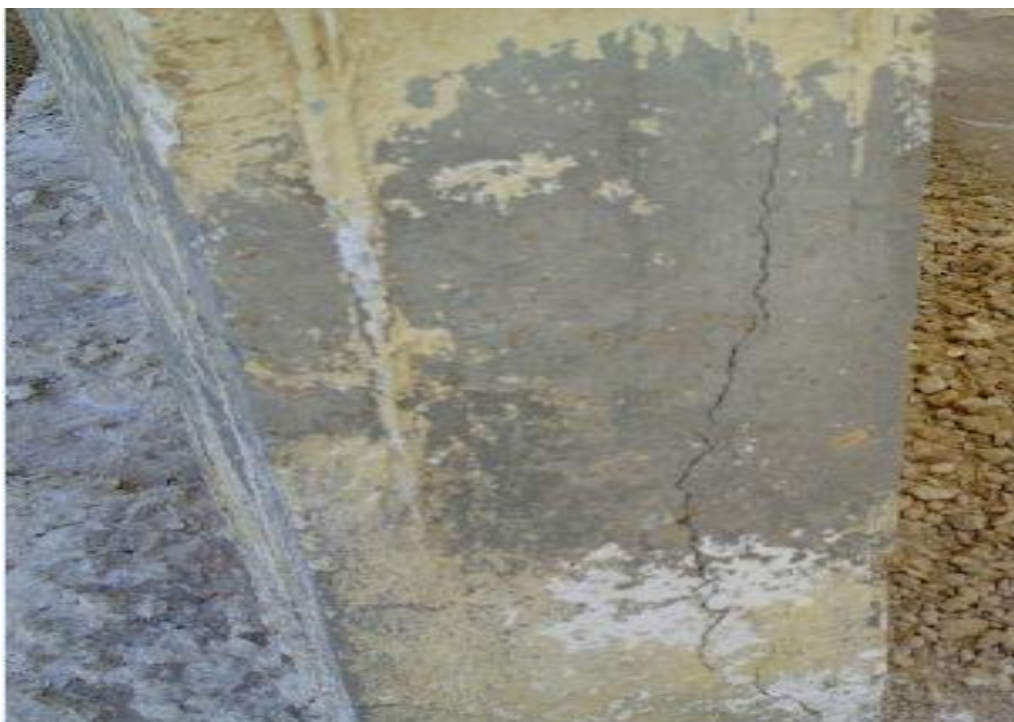
Photo.04: Fissure axiale sur un poteau en BA
