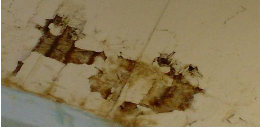
Photo.06.: Eclatement du béton en certains endroits de la coupole inférieure
