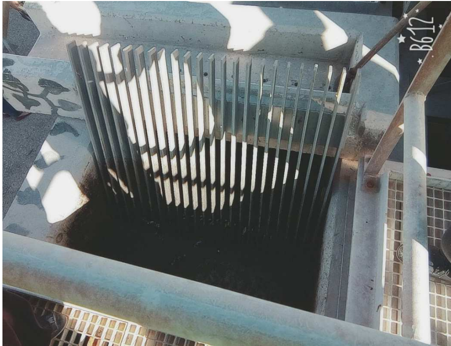
Photo IV.3. Dégrillage (station de Hassani Abdelkrim).
