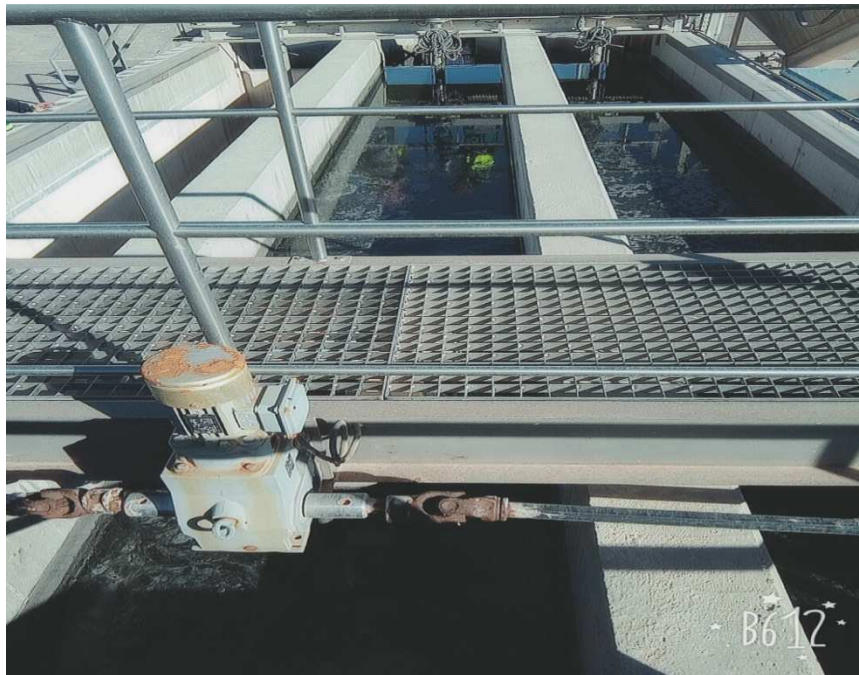
Photo IV.4. Dessableur (station de Hassani Abdelkrim).
