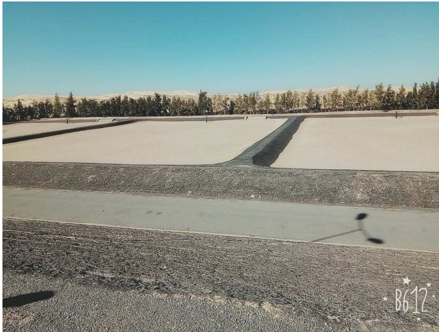
Photo IV.6. Lits de séchage des boues (station de Hassani Abdelkrim).
