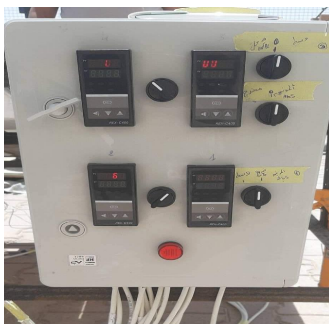
Photo III.11: Armoire de mesure de température.
