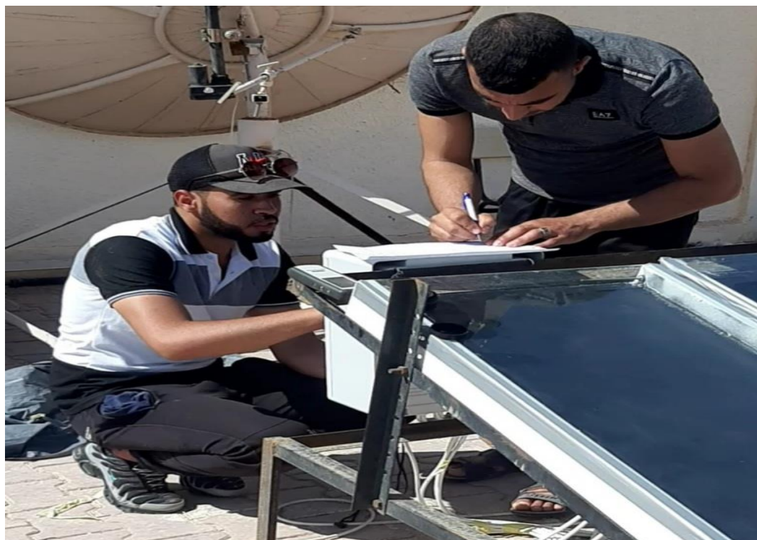
Photo III.20: Mesure des températures à partir d'armoire.
