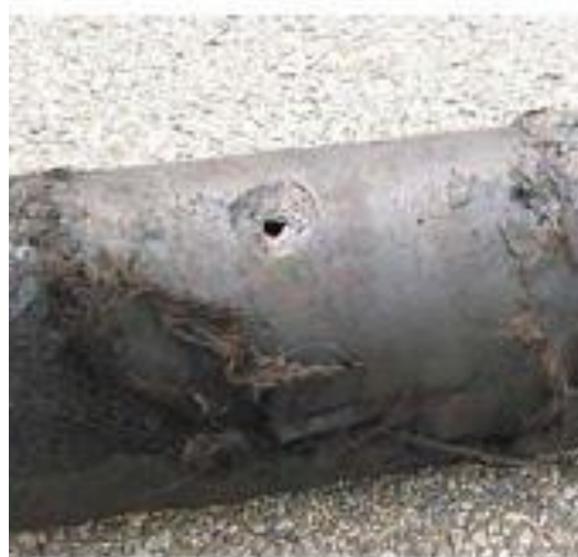
Figure 1 : exemple de corrosion par piqûre
