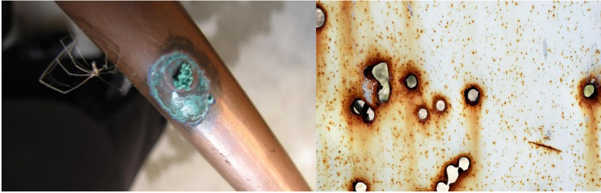
Figure 8 : Exemple de corrosion par piqure
