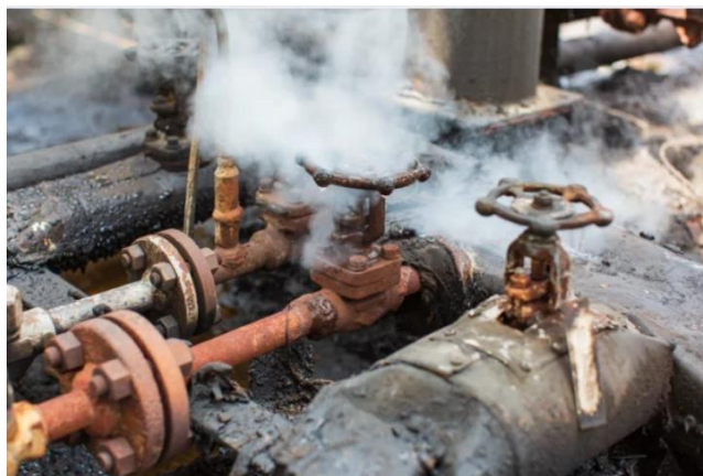
Figure 3 : Exemple de corrosion par gaz
