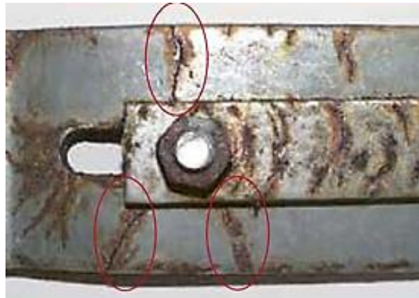
Figure 5 : Fissuration par corrosion sous contrainte
