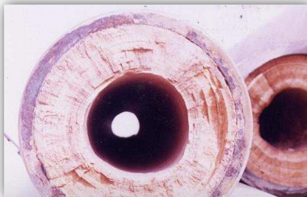
Figure I.6: Une conséquence de la formation des dépôts dans les conduites.
