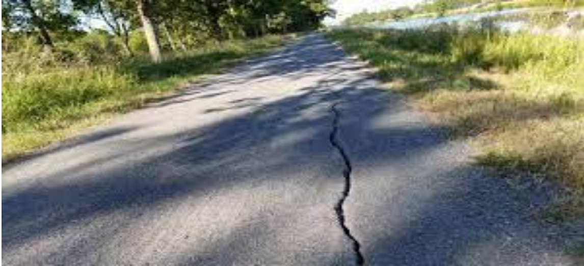
Figure 2.3 : Fissures de rives
