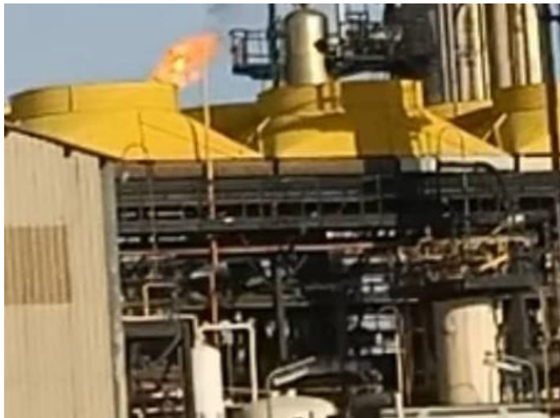
Figure (II.6) : Les aéroréfrigérants secs de l'unité U800
