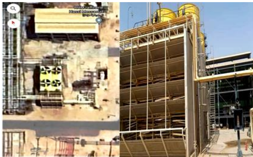
Figure (III.1) : Aéroréfrigérants installés à la raffinerie RHM2
