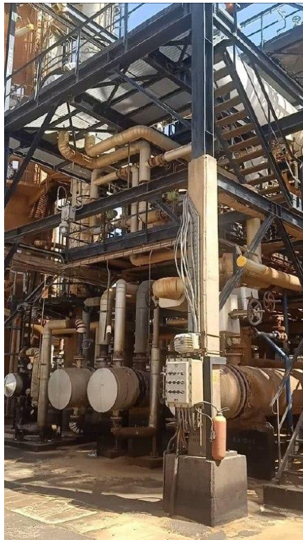
Figure (II.1): Les échangeurs de chaleur réel de l'unité U800
