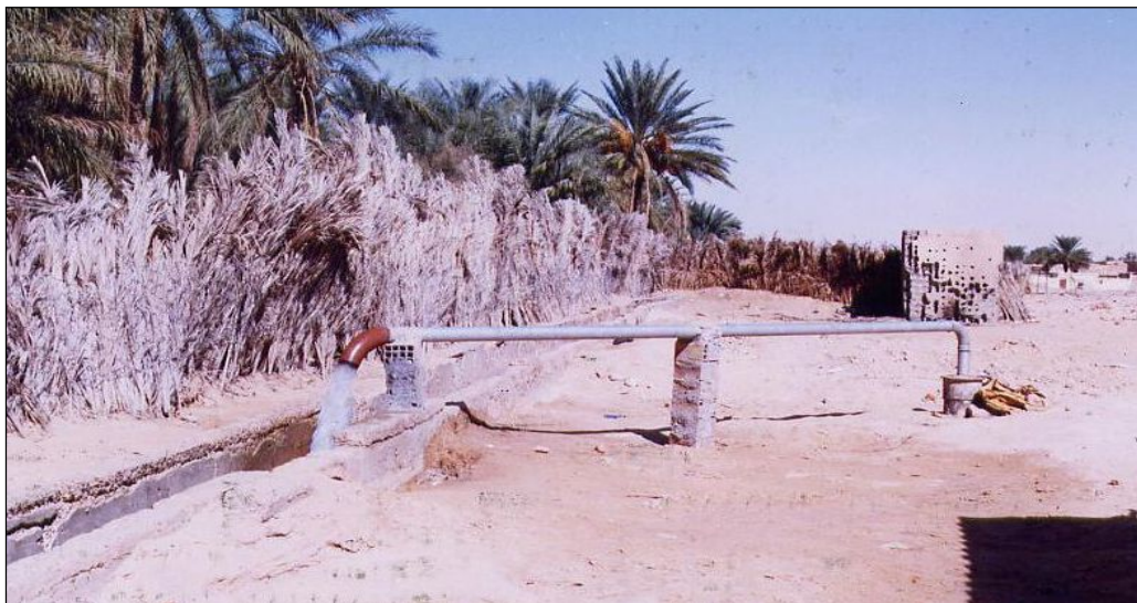
Photo (II-1): d'un forage du Complexe Terminal (2 ème nappe) à Sidi Mahdi.
