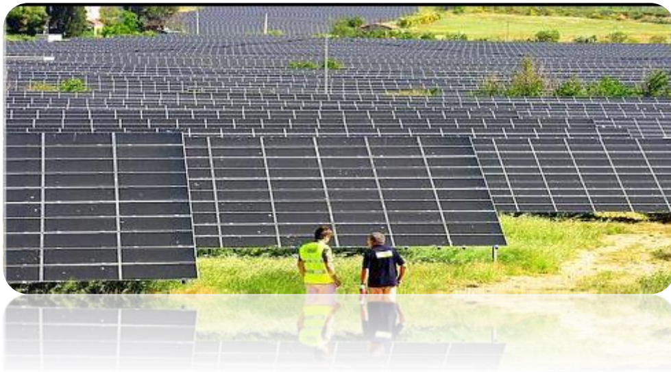
Figure II.1: un exemple d'un champ photovoltaïque
