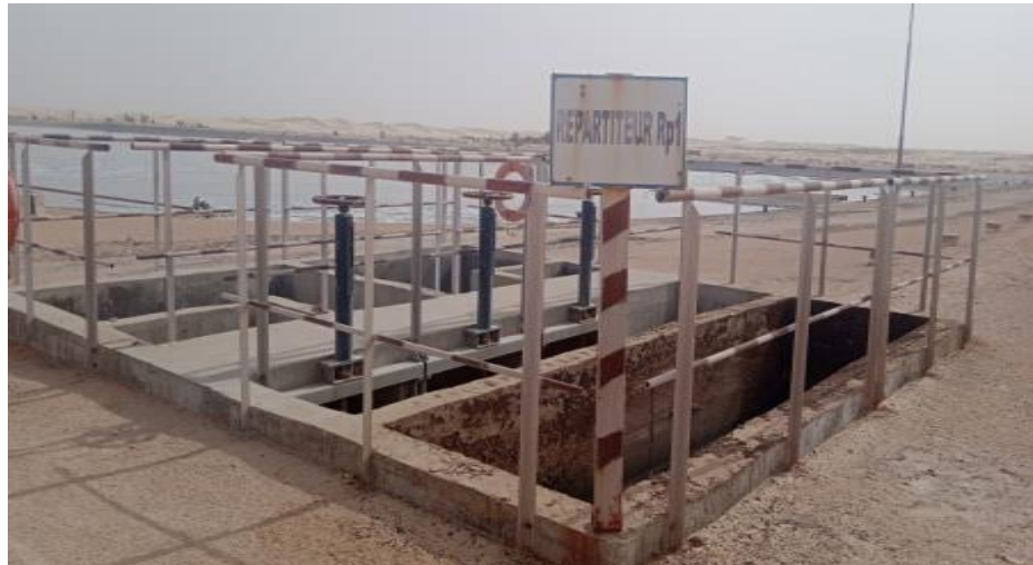
Figure26: Répartiteur vers les bassins d'aération (R1.R2/R3) (ONA, 2022)
