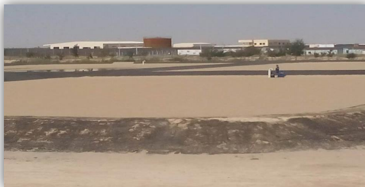
Figure30: Lit de séchage des boues(ONA, 2022)
