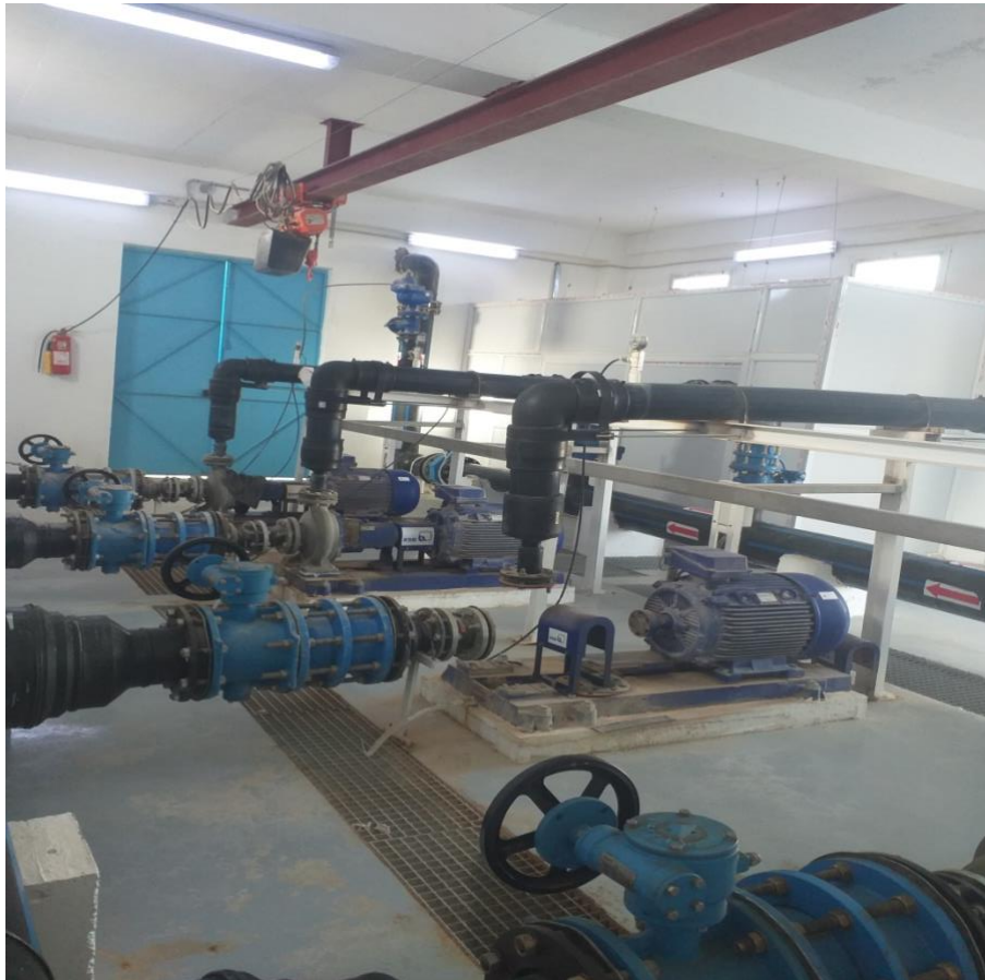
Image 12: Pompes de rejet
