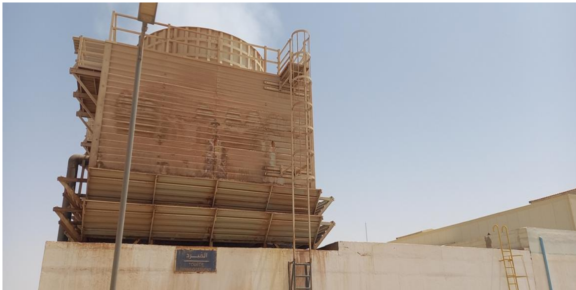
Image 4: tour de refroidissement
